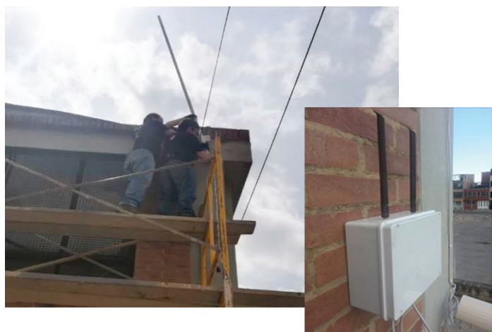
Figura 1. Izquierda: instalación de antena Nanostation M5 para enlaces troncales. Derecha: enrutador para redes en malla y punto de acceso. Fuente: Elaboración propia.
