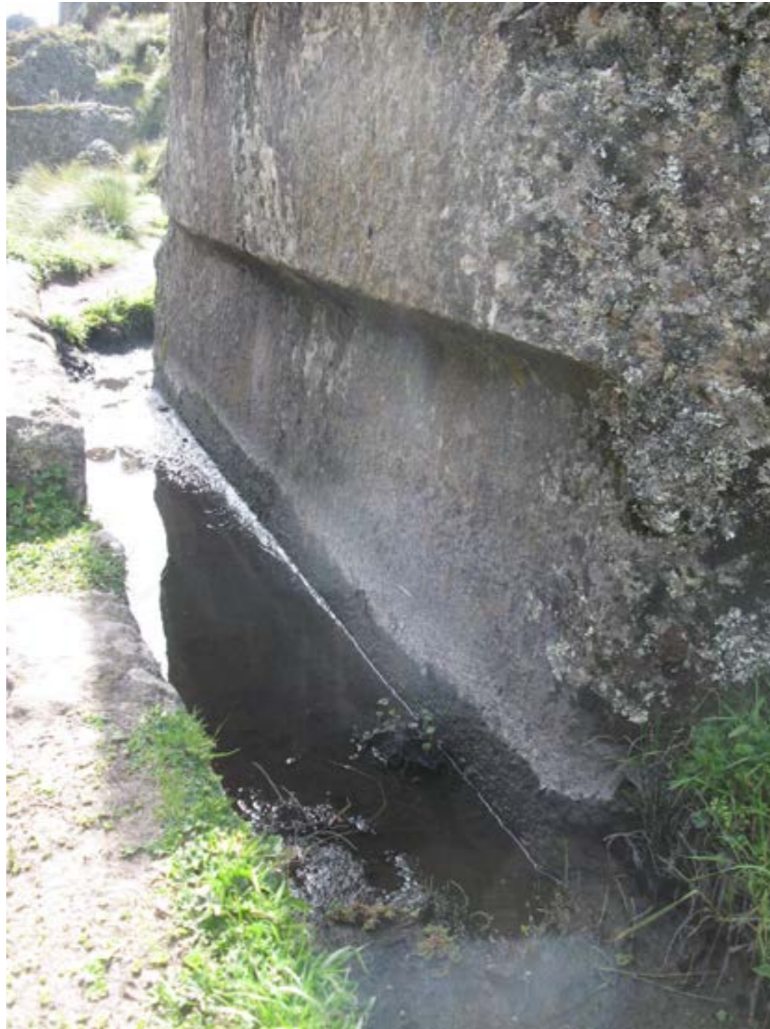
Figura N° 17. El Segmento II del canal continúa sobre bases artificiales (rellenos) y excavación en la roca.
