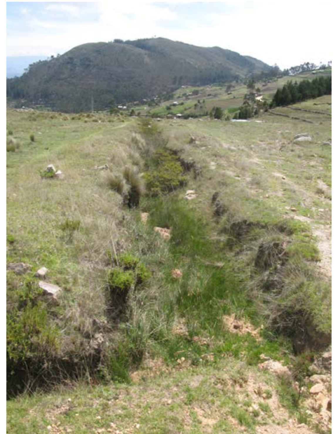
Figura N° 26. Segmento III del canal, hacia Layzón - Cajamarca, en estado de abandonado.
