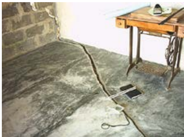
Figura 6. Muestra de cómo una grieta afectó a una residencia.
