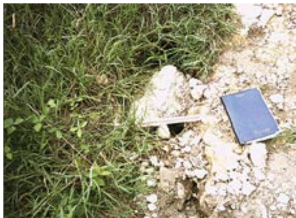
Figura 5. Grieta de 0,33 m.
